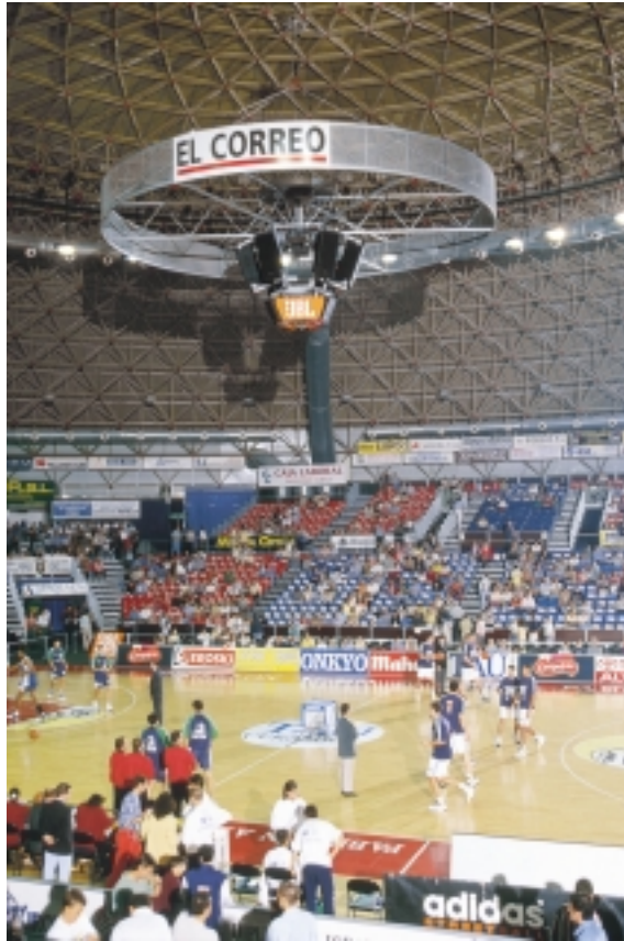
Fig. 3.16 Pabellón Polideportivo de Zurbano (Vitoria, España) con el sistema de megafonía instalado
