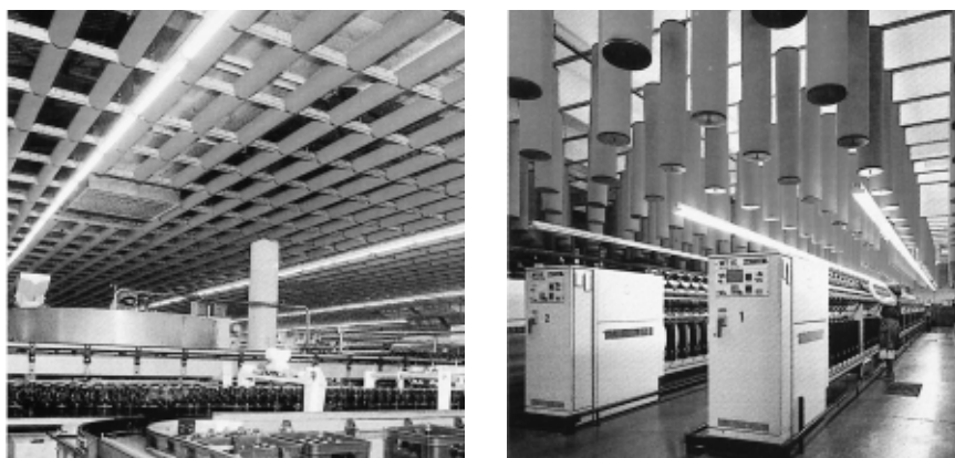
Fig. 2.19 Ejemplos de tratamiento acústico a base de cilindros absorbentes de lana mineral (Sonover de Wanner y Vinyas, S.A.)
