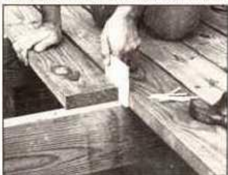
14. Mantenga un espaciamiento uniforme entre las tablas del piso de la cubierta, usando un espaciador de madera. Los extremos de las tablas quedarán sobre el centro de los cabrios
