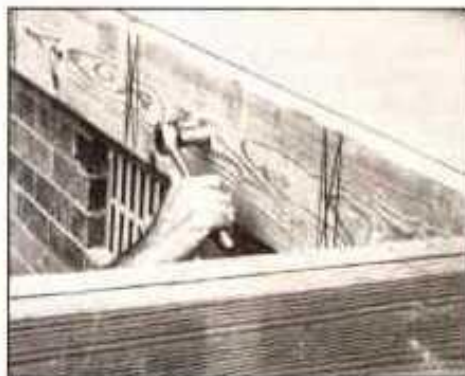
8. Primero fije el larguero a los cabrios de extremo, luego sostenga el conjunto y fíjelo a la pared de la casa como una unidad. Más tarde apriete firmemente los espárragos del larguero
