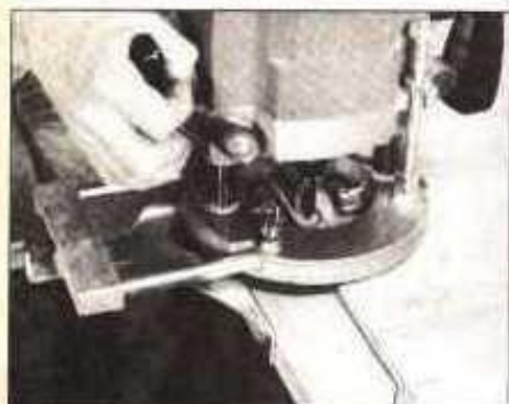
Empleando una rebajadora con una guía de borde fijada a ella, corte una mortaja de poca profundidad en el fondo del tablero y la hoja caediza para dar cabida a una bisagra continua
