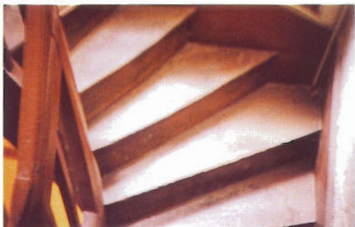
Peldaños radiales en pilarete interrumpido en una escalera suspendida
