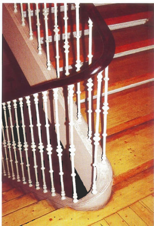
Las barandillas de hierro colado pusieron en evidencia los estrangulamientos de las zancas. Escalera oblonga
