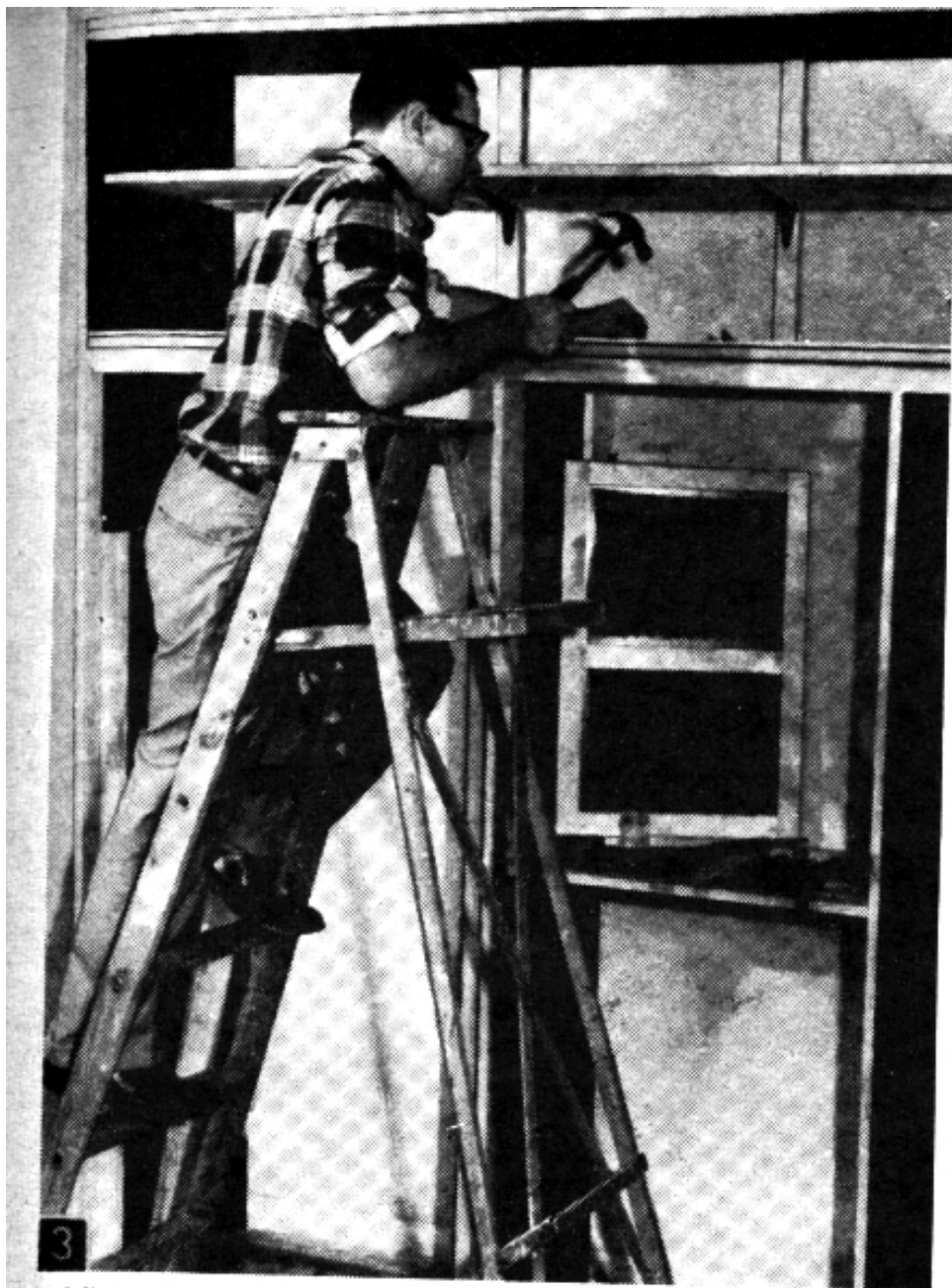
3 Añada la rodada de la puerta de madera de \frac{1}{4} " para las puertas corredizas después de clavar madera dura en la parte superior, el fondo, y los lados de la unidad.
