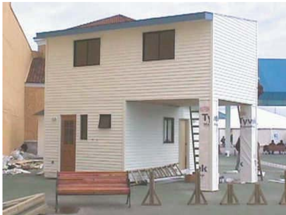
Figura 18 - 23: Revestimiento en moldura de 3/4" x 5" tinglado, con tratamiento superficial y terminación con pintura acrílica.
