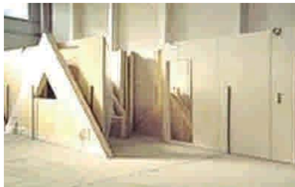
Figura 6 - 5: Estructuras preparadas (tabiques, frontones) para ser trasladadas al lugar donde se está construyendo.
