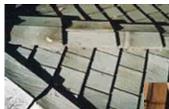
Cubierta de madera sin mantención
