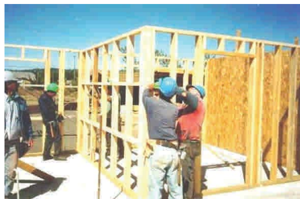
Figura 10 - 73c: El elemento finalmente es levantado, anclado y fijado sobre su eje de ubicación de forma rápida y expedita.
