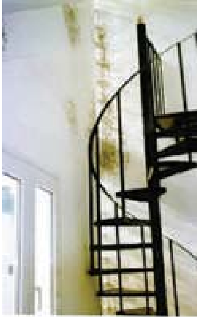
Figura 13 - 12: Formación de hongos en la superficie que se traduce en manchas, por efecto de la humedad por condensación.
