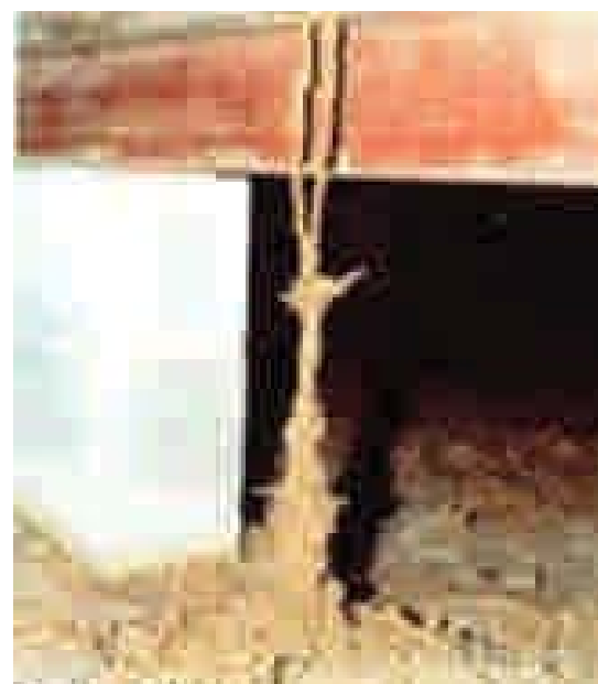
Figura 2 - 12: Túneles generados por las termitas subterráneas desde el terreno al friso, formando túneles con barro protector llamados tubo refugio. Conformados por fragmentos de tierra y madera digerida cementada con excrementos de las termitas obreras.
