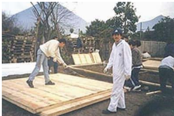
Figura 1 - 66: Mediaguas de madera construidas en contacto directo con el suelo (construcción de emergencia).
