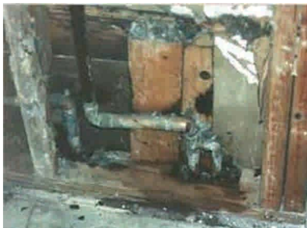
Figura 2 - 13: En tabique sanitario, la presencia de humedad por una pequeña filtración de la cañería de agua, crea el ambiente propicio en el interior del tabique para la presencia de termitas subterráneas. Se puede observar la destrucción del pie derecho y solera inferior.
