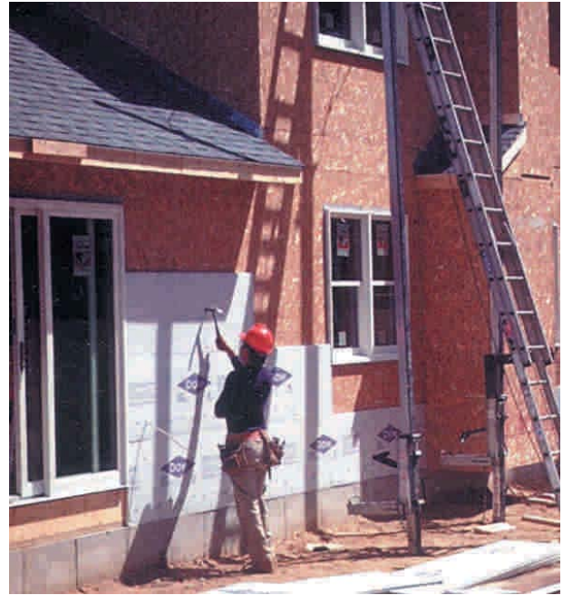
Figura 4 - 14: Las escaleras no deben ser estructuras fabricadas improvisadamente en obra. Es recomendable el uso de escaleras metálicas.
