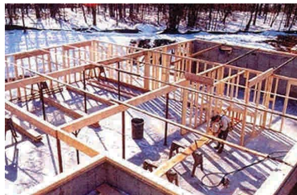
Figura 10 – 31: Tabiques ya estructurados en el primer piso de una vivienda. Durante el proceso de clavado y fijación, es primordial el control geométrico como: alineación, verticalidad (plomada), anchos, largos y espesores con respecto al diseño planimétrico y altimétrico de la vivienda.
