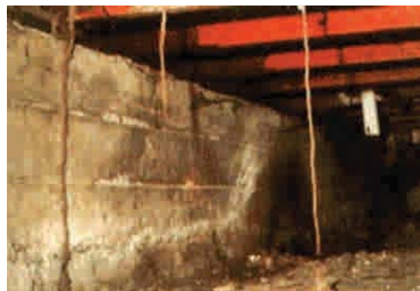
Figura 2 - 11: Túneles elaborados por termitas subterráneas desde el terreno, el cual contiene una humedad permanente por no estar ventilado en la zona bajo la plataforma.
