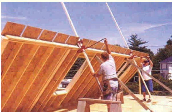
Figura 6 - 10: Una vez fabricados los tabiques sobre la plataforma, se procede a izarlos y ubicarlos en el lugar correspondiente.
