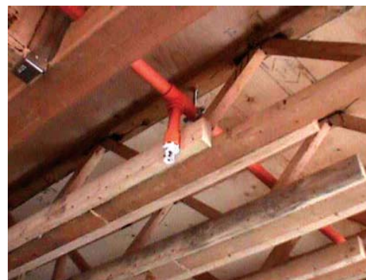
Figura 15 - 7: Sistema activo para el combate de incendio, consistente en dispositivo sprinkler (rociador) que requiere una instalación de red con agua a presión, independiente a la red de agua de abastecimiento del edificio. Se activa automáticamente ante un aumento desmedido de la máxima temperatura aceptada para el medio.
