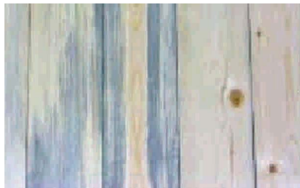
Figura 2 - 4: Piezas de madera machihembrada de Pino Radiata, la que fue atacada por hongos cromógenos estando encastillada.
