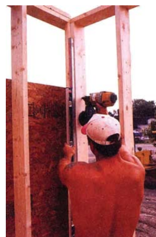
Figura 10 – 32: Clavado de un encuentro entre tabiques con control de verticalidad (nivel de mano), según la descripción anterior.
