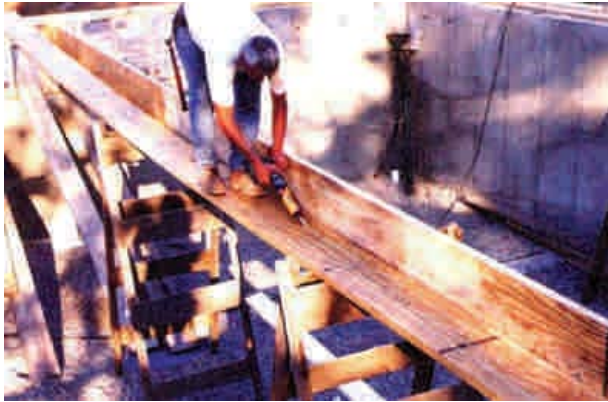
Figura 9 - 55: Armado de la viga maestra compuesta, colocación de adhesivo para madera entre las piezas que permite reforzar la unión de éstas con la colocación de clavos alternados cada 15 cm.
