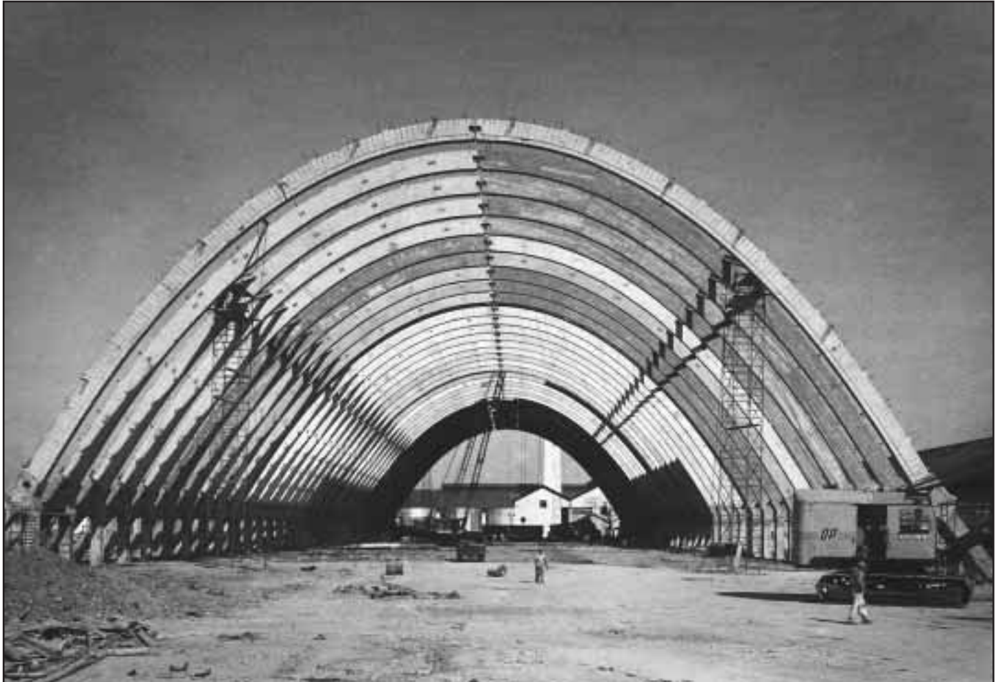
Almacén de azúcar a granel en construcción con elementos prefabricados de hormigón
