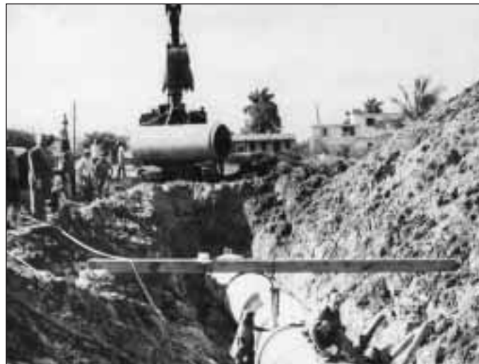
Segunda Ampliación del Acueducto de Albear
