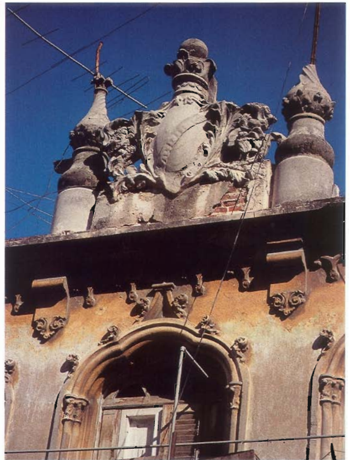
Coronament de la casa Espinosa (1910), en un estat precari de conservació Coronamiento de la casa Espinosa (1910), en un precario estado de conservación
