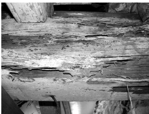
Fig. 11.3. Jácena atacada por termitas.
