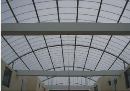
Figura No 70 Cubierta de policarbonato
