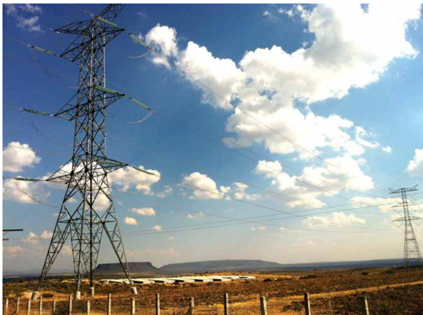
Línea de transmisión eléctrica de 230 kV.
