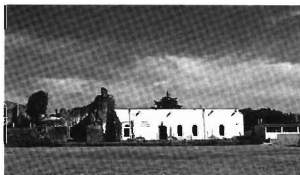
Imagen 11. Vista del conjunto conventual de Ocuilan que ha perdido los elementos característicos del atrio, así como la capilla abierta. El templo se encuentra en estado de ruina.
