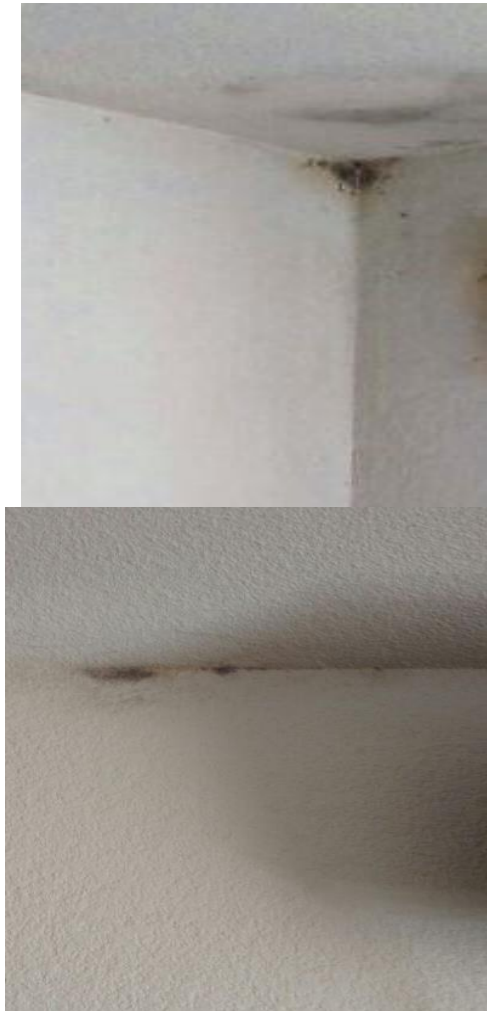
FOTO 1. Humedad en muros. Fuente: Araceli López
