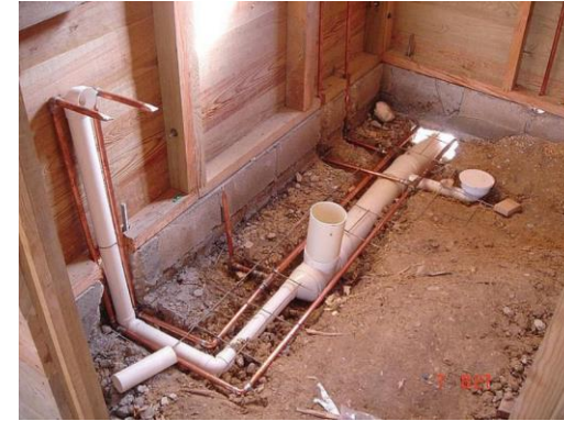
Imagen 12. Instalación sanitaria. Obtenido de: http://xalapa.infoinfo.com.mx . Enero2017
