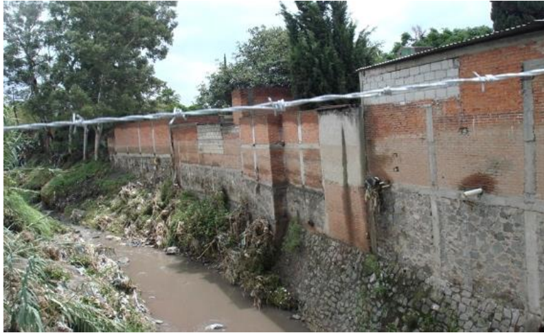
Imagen 9. Asentamientos en las márgenes del río alseeca en la colonia Joaquín Colombres (Febrero 2017) fuente MALP
