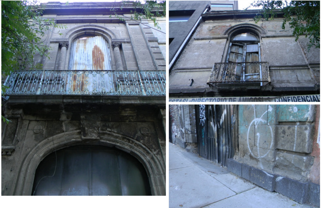
Figs. 9, 10 y 11 Fotografías del estado que guarda la fachada de nuestro inmueble de estudio (Fotos Fdo. Ortiz).
