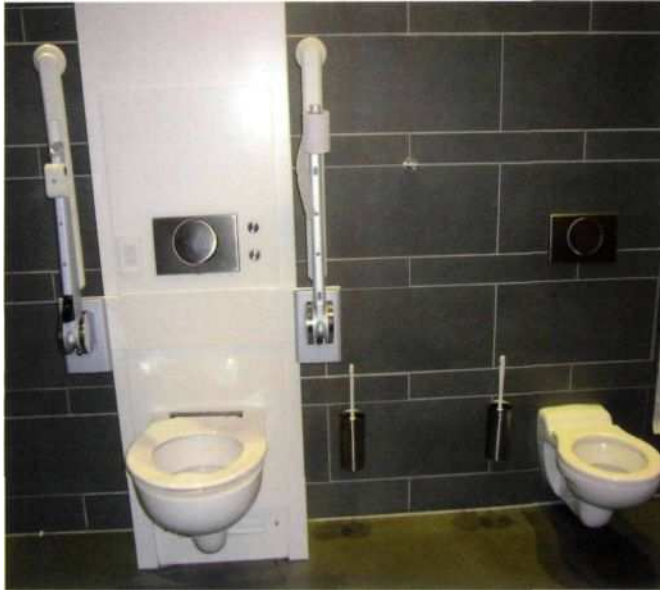
Servicio higiénico en la Estación Central de Berlín (Alemania). Se apuesta por dar respuesta a las necesidades de todos los usuarios.
