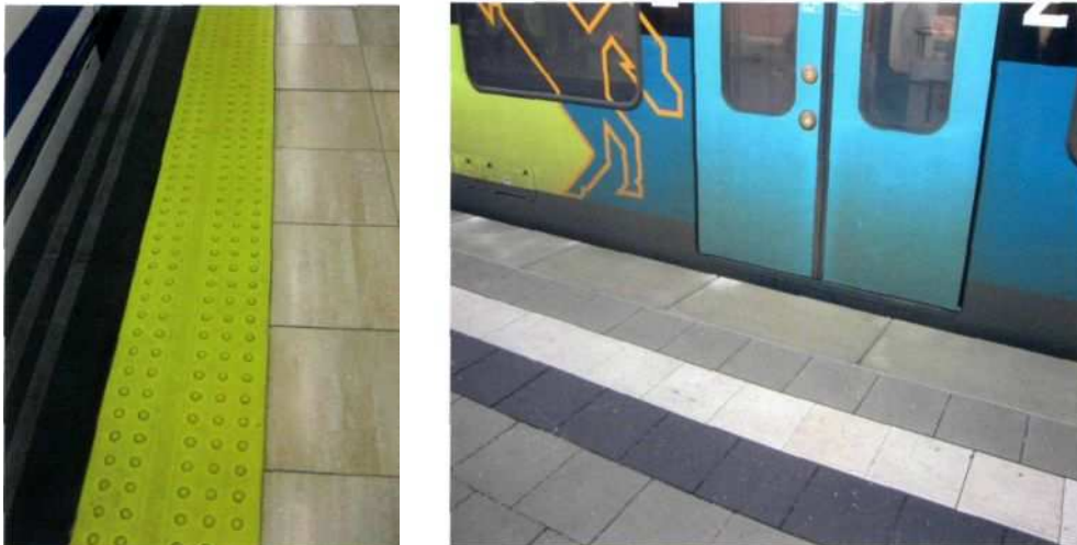
Señalización de borde de andén mediante la utilización de pavimentos tactovisuales que facilitan la detección del mismo a las personas con discapacidad visual.
