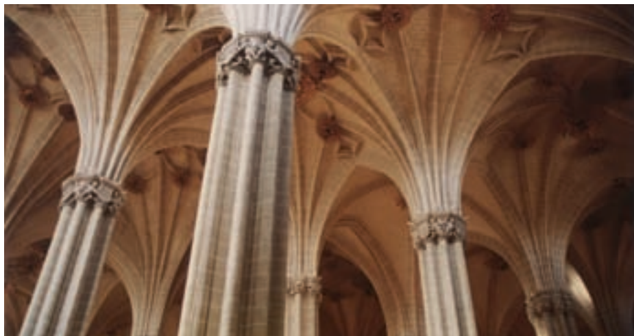
La Seo de Zaragoza, vista parcial de las bóvedas después de la intervención
