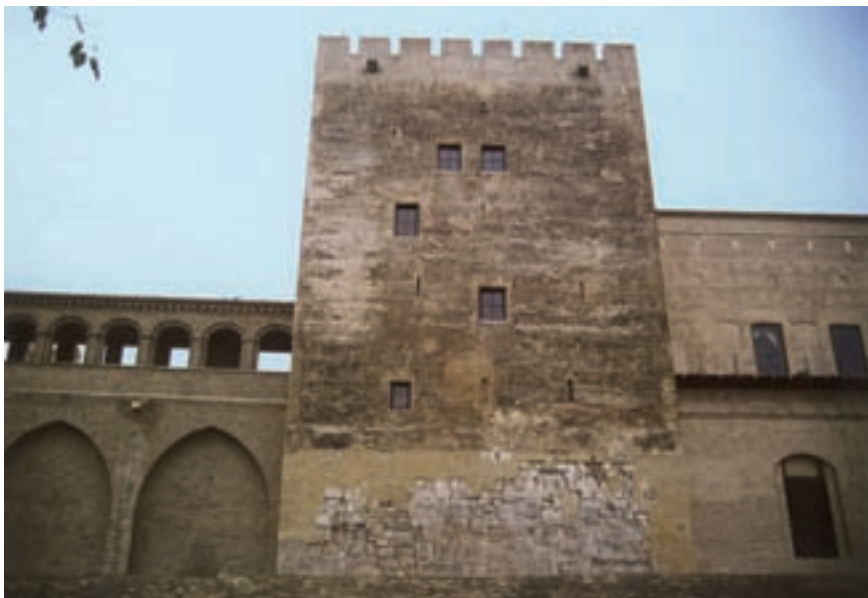
Monasterio de Sijena, torre del Trovador, vista de su cara norte después de la intervención
