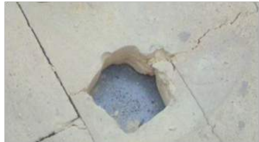
Perforación realizada en el piso del horno
