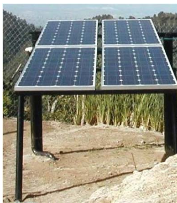
Figura 4. Conjunto de paneles fotovoltaicos típico y su estructura metálica de soporte.
