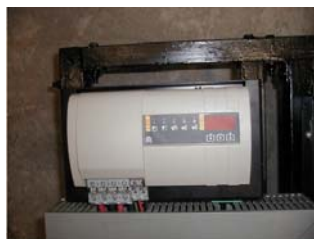
Figura 6. Típico regulador de carga fotovoltaico con sus respectivos bornes de conexión para el módulo, para la batería y para las cargas.
