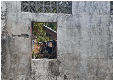
Imagen 9. Vivienda colapsada por sismo
