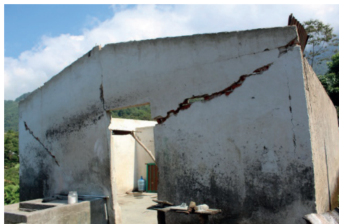
Imagen 10. Vivienda de El Plan, colapsada
