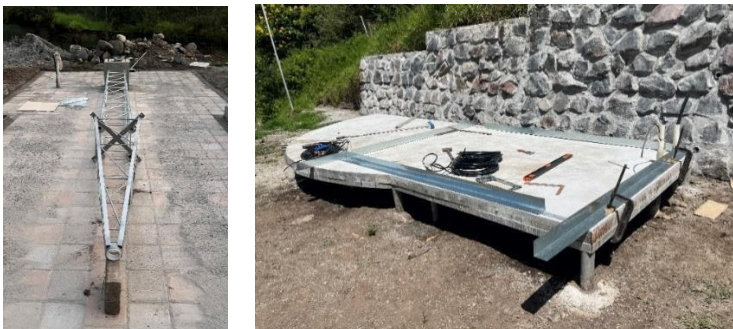
Ilustración 5. Fotografía de comprobación de estructura portante y plataforma de cabina de mando - Quito, Ecuador (Urueña W, 2023)
