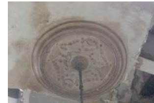
Moldura de yeso en luminarias
