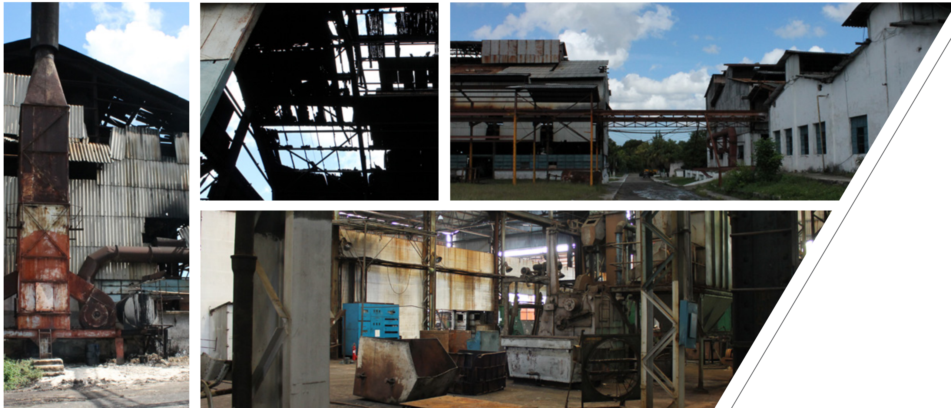
// Las áreas destinadas a la producción muestran un grave estado de deterioro.
