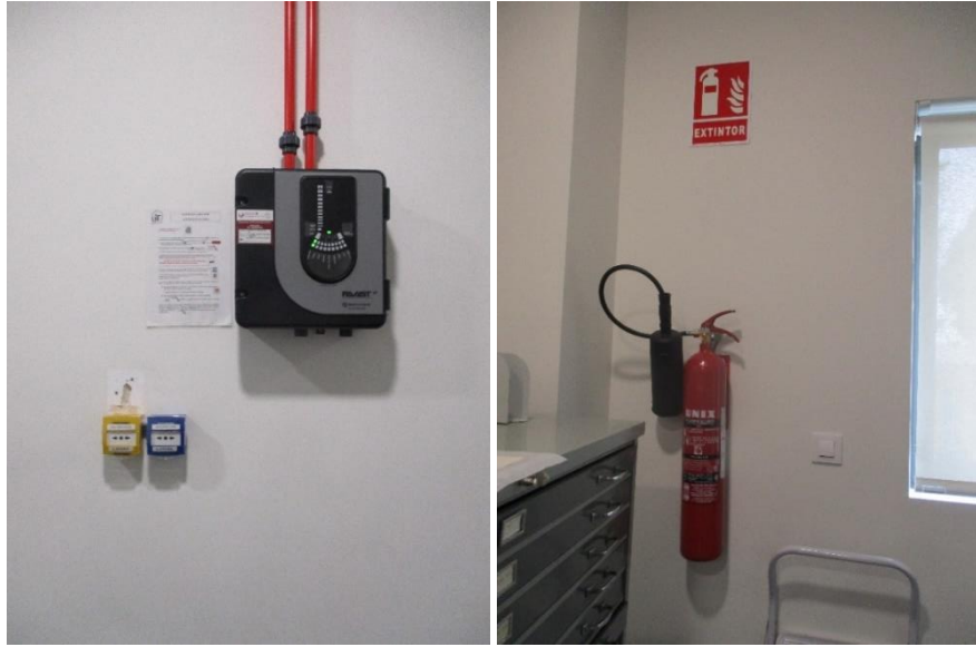
Fig. 29. Sistema FAAST de detección de incendios y extinción automática por agua nebulizada. Fuente: Blanca Galán Gil.
