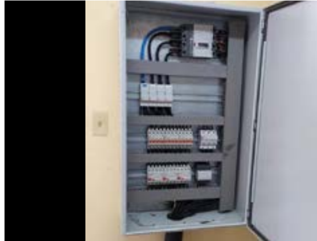
Caja para protecciones
