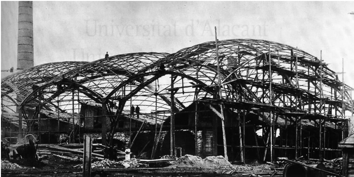
Imagen 99: Cubiertas reticuladas comprimidas para la "Exposición Industrial y Artística de toda Rusia" de 1896 en Nizhni Novgorod. Ilustración extraída de " Vladimir G. Shukhov e la leggerezza dell'acciaio " (Giovannardi, 2007A, p.20).
