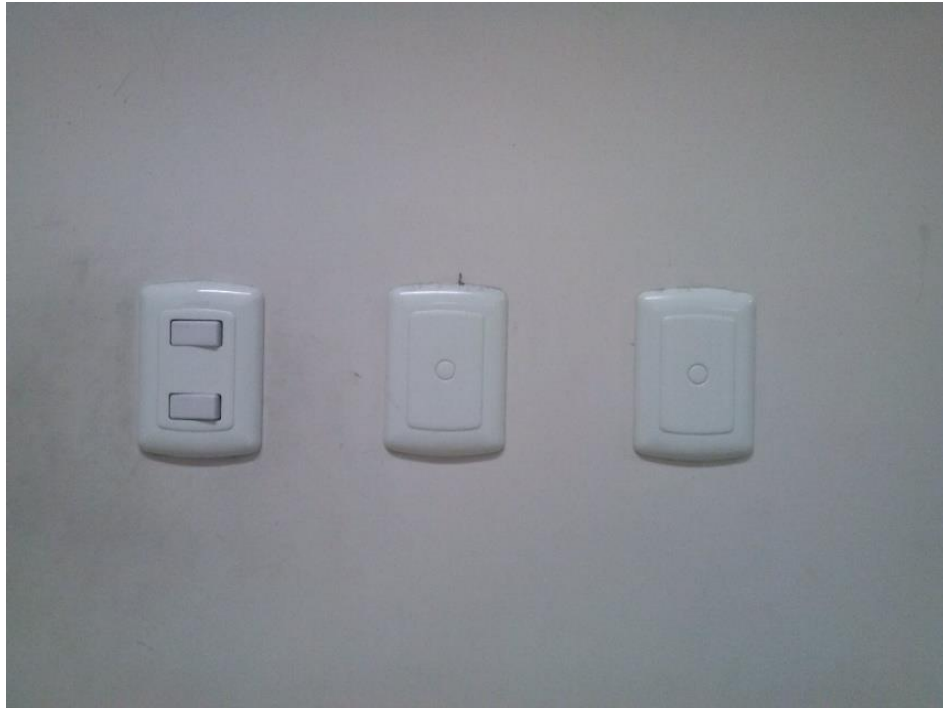
Fig. 63: Cajas empotradas para conexión eléctrica
